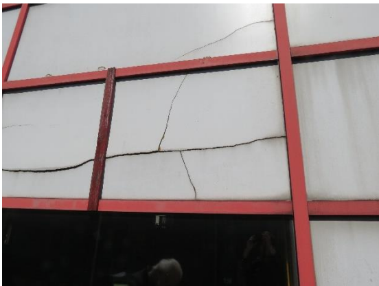
Afb.7. Gebarsten gevelplaten, rechter zijgevel.
